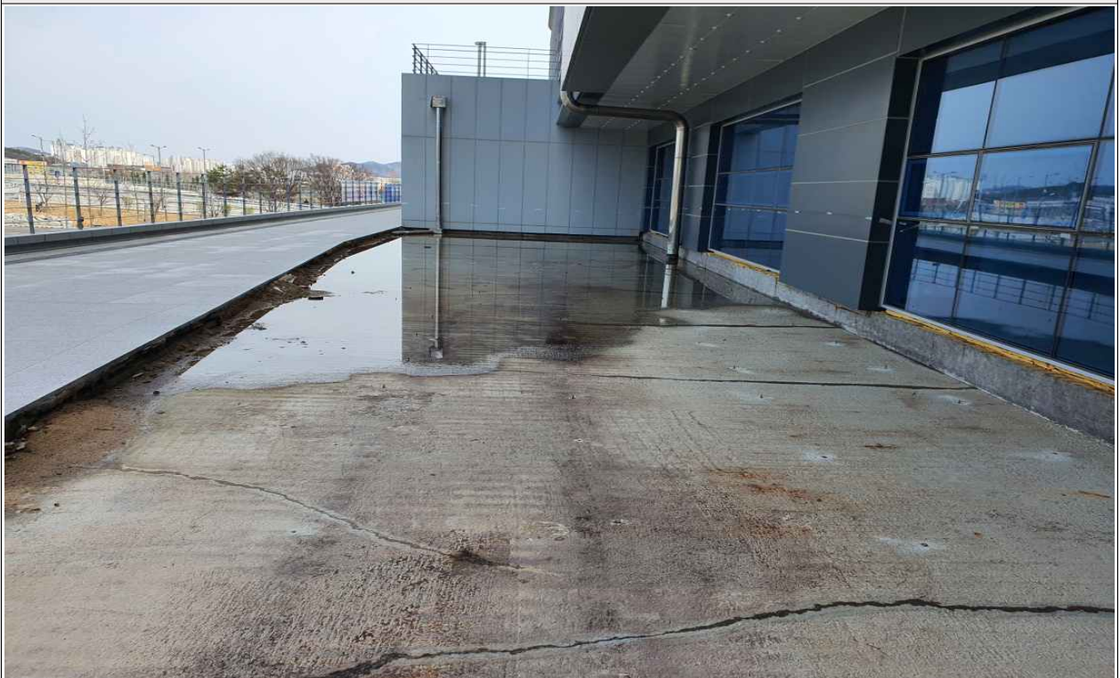
구미시복합스포츠센터 누수 하자(데크 철거 후)
