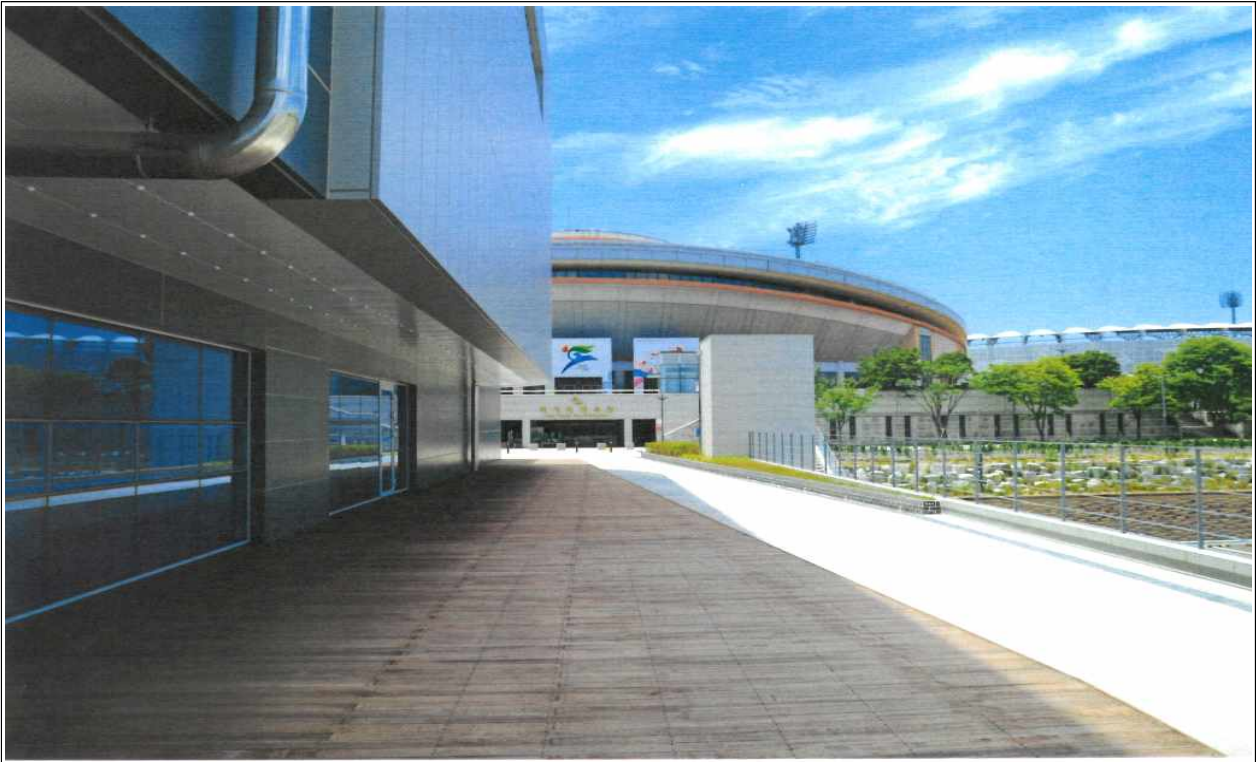
구미시복합스포츠센터 누수 하자(데크 철거 전)
