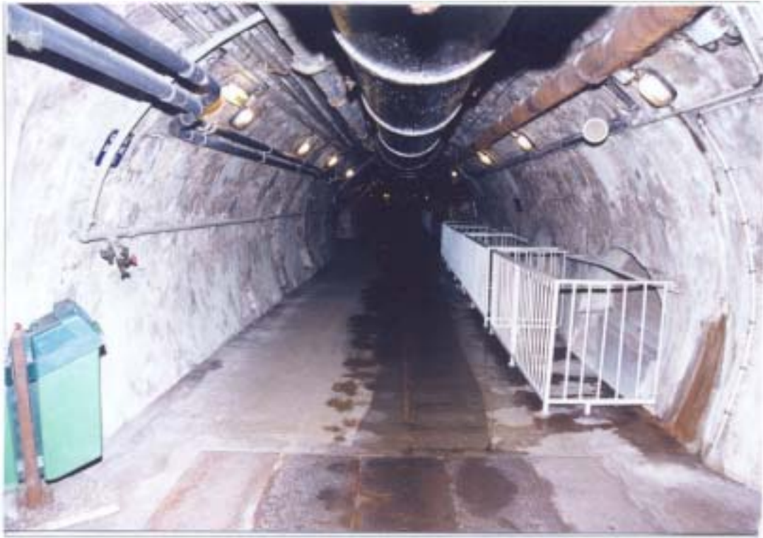
◀ 하수처리장 내 지하공동구 ▶
